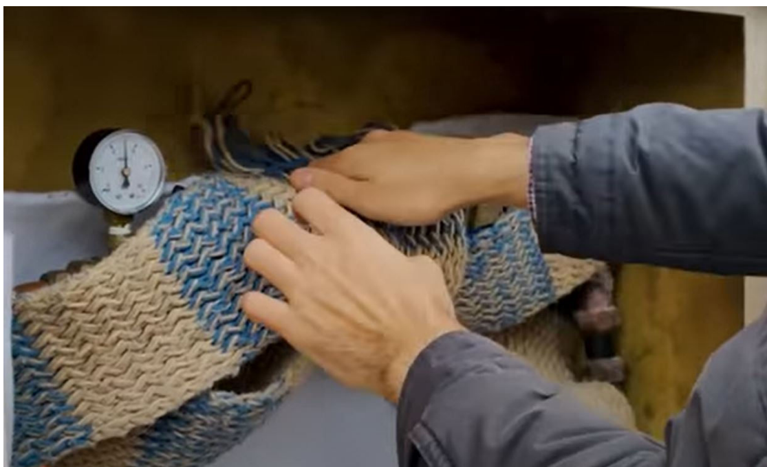
Tuberías "abrigadas" Canal de Isabel II Canal de Isabel II
