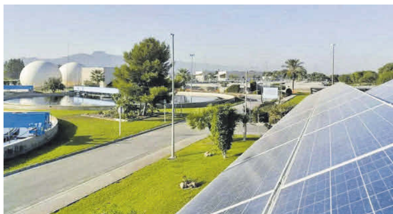
Placas fotovoltaicas en la EDAR para aprovechamiento de energía en la planta. | Aguas de Murcia
